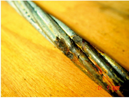
Fig. 11. Corrosion galvanique d'un toron galvanisé par couplage galvanisation/acier.
